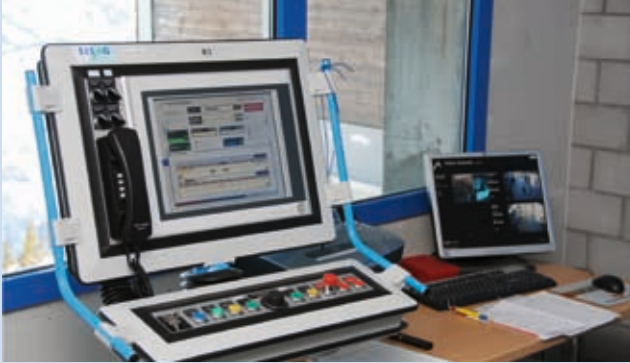
Die hochmoderne Steuerungsanlage von der Sisag beinhaltet eine audiovisuelle Überwachungsanlage.
